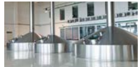
Équipement de production de brasserie
