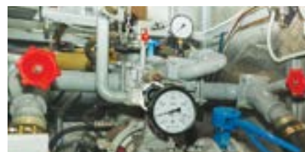
Contrôle de pompes et vannes
