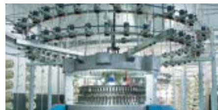
Automatisation de machines à filer
