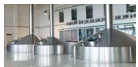
Équipement de production de brasserie
