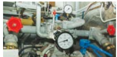
Bombas y control de válvulas
