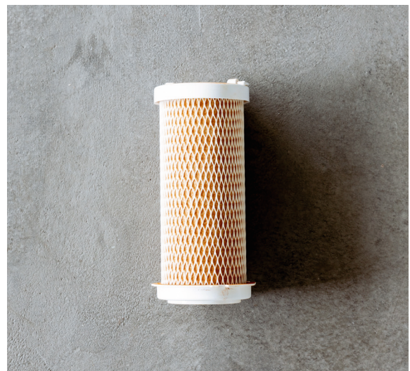
Estado del filtro después 4 meses
