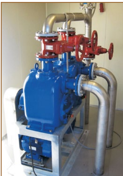
Sewage lift station Abwasser- Hebewerk
