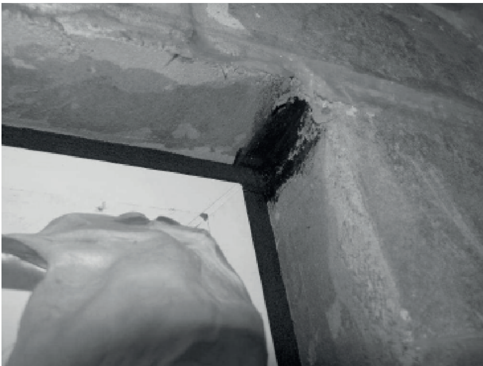
Bild 4 Detailansicht raumseitige ECKAUSBILDUNG oben (Putzriss mit blaugelb Multikraft Extrem Dicht- und Klebstoff abgedichtet).
