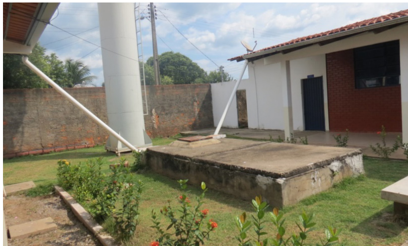
Figura 4 – Captação de água da chuva utilizada nos serviços de limpeza da escola
