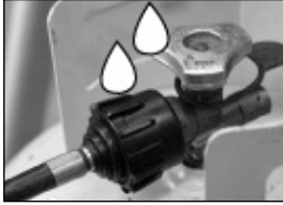
Fuga Regulador y manguera
