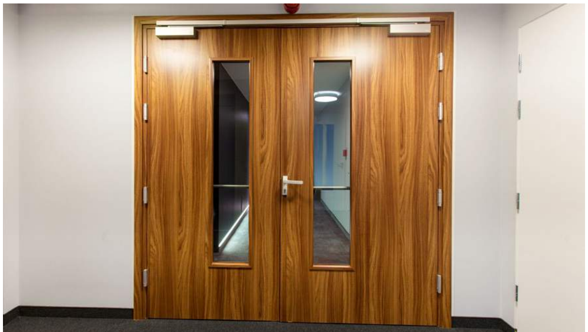
FR EI30 fire door, fixed wooden door frame
