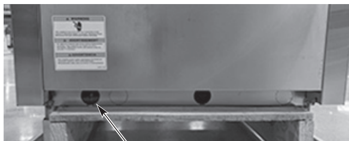
ELECTRIC CONDUIT HOLE
