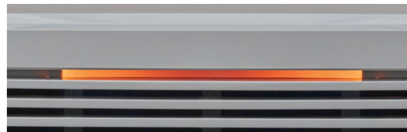
Orange Light / 汚れている
