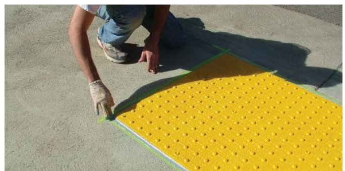
Apply sealant around outside edges of tile. Aplique sellador al rededor del border del azulejo.
