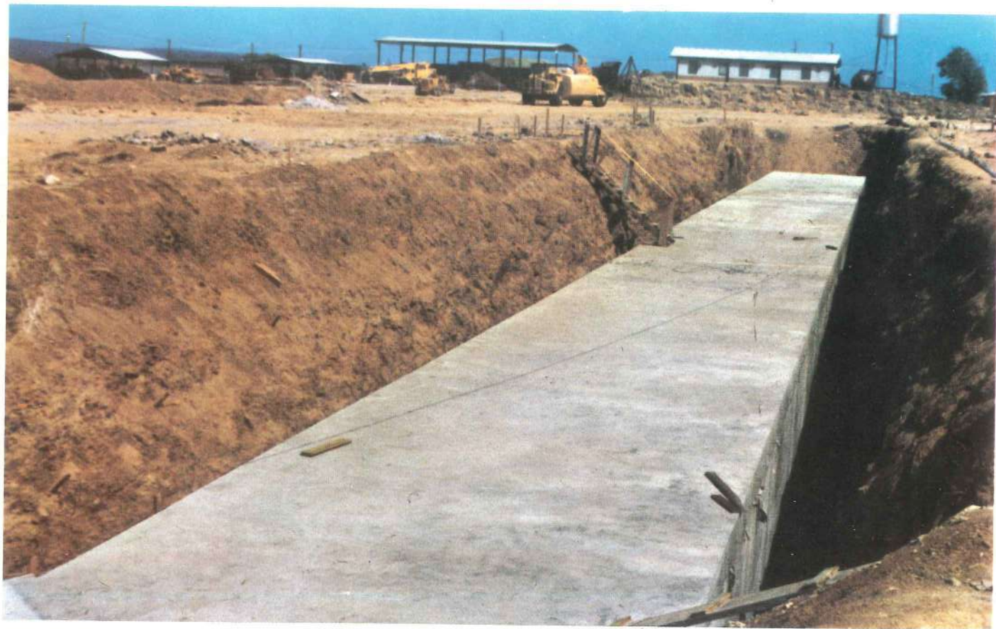
Canale di scarico
