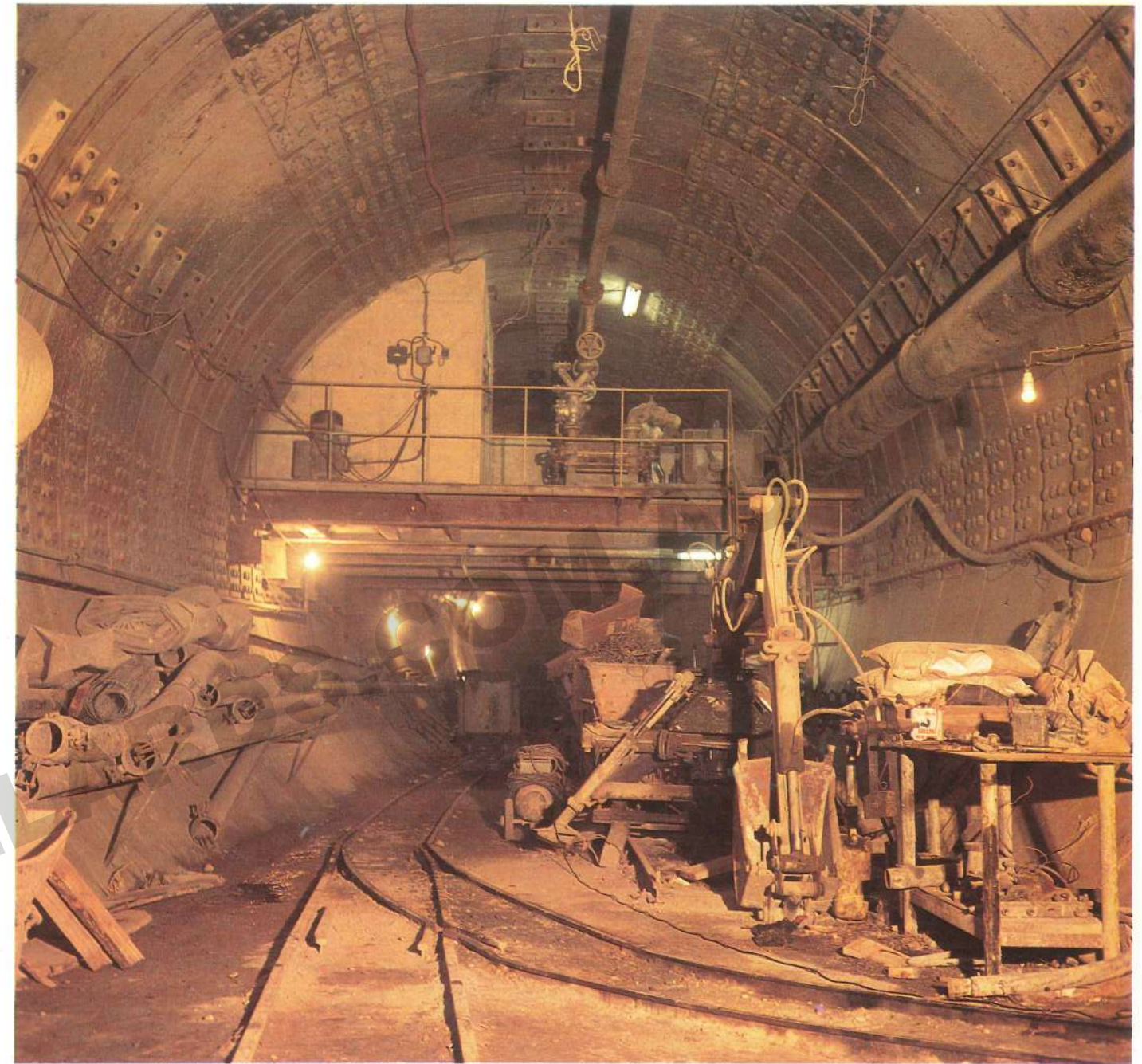
Camerone al nodo pozzo - galleria alla profondità di circa m. 500 dalla superficie
