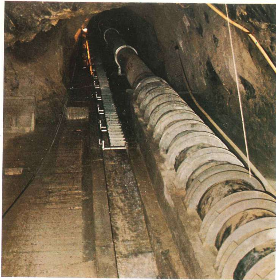
La condotta in rimonta con l'85% di pendenza Pipeline in a slanting shaft with an 85% gradient
