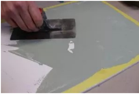
stap 3: zodra de grondering met Caseïnegrondering en de basislaag met Hechtpleister fijn droog zijn, wordt Stucco fijn (hier gepigmenteerd volgens kleur 134 uit de kleurenwaaier) licht gestructureerd gespateld.
