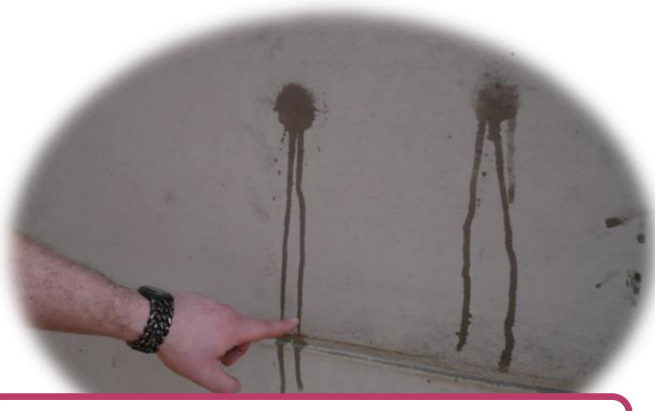
BETONNEN PLAAT : Niet zuigende ondergrond, want het water loopt af zonder te absorberen
