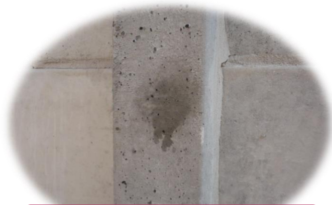
BETONNEN PAAL : Zuigende ondergrond
