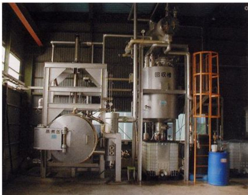
図一 1 (特許) ドリユアス社の加圧抽出設備 写真
