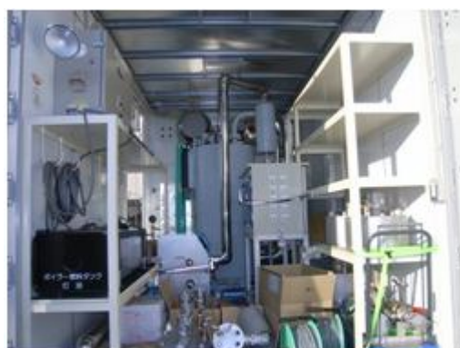
図. 6 ボイラー車内設備
