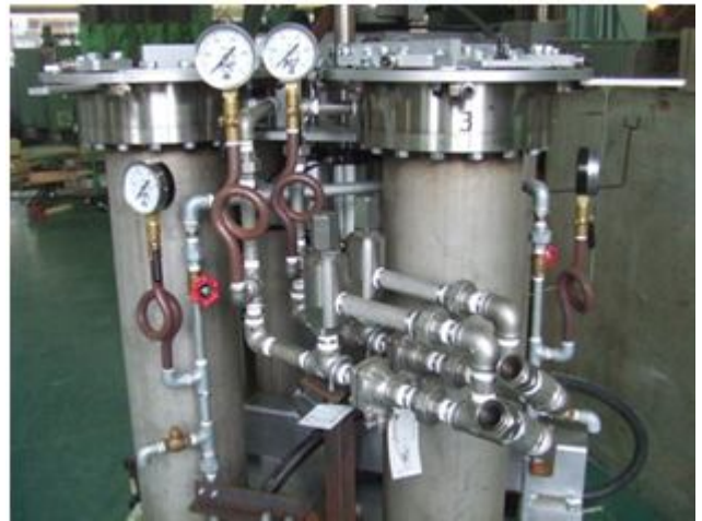
Pic.2 圧力調整及び排気部分
