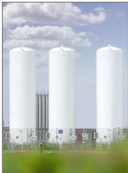
AC SCS.1 Línea de tanques verticales a granel
