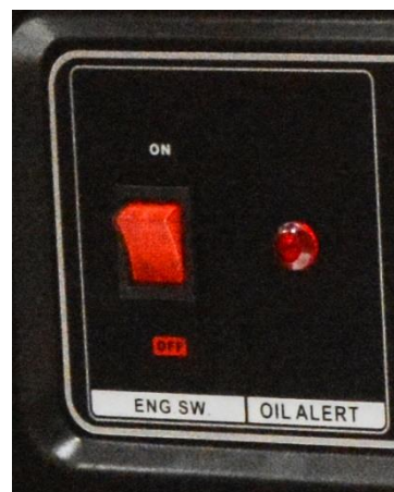
Figura 24 – Interruptor de control del motor
