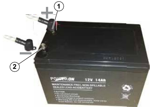
Figura 8 – Conexión del cable (negro) negativo (-) de la batería
