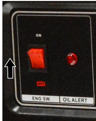
Figura 19 – Interruptor de control del motor
