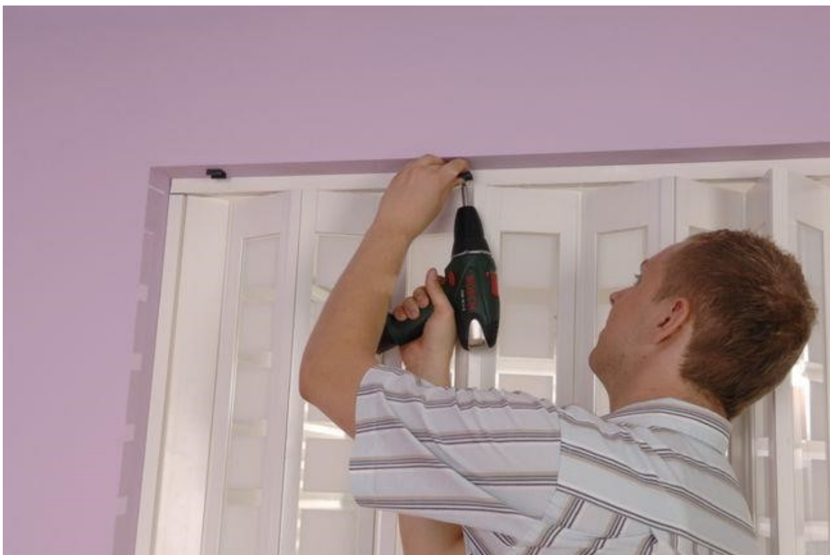
Afbeelding 35 van 37: De gaten voor de bevestigingsclips van het paneel worden gemarkeerd, geboord en vervolgens worden de clips vastgeschroefd.
