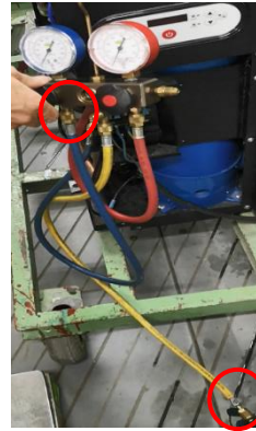
Remover a bomba de vácuo
