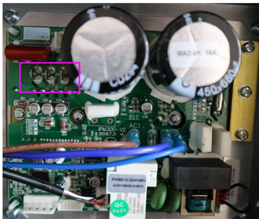
Placa do inversor (modelo monofásico)
