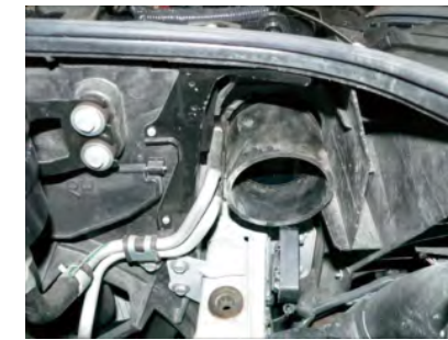
9.配置した導入ダクトにエンジンルーム側からゴムホースを約30mm挿します。(左右)
