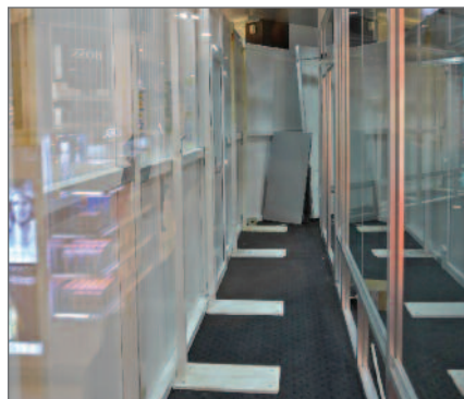
Installation à l'aéroport de Bâle-Mulhouse (installation vue côté chantier)
