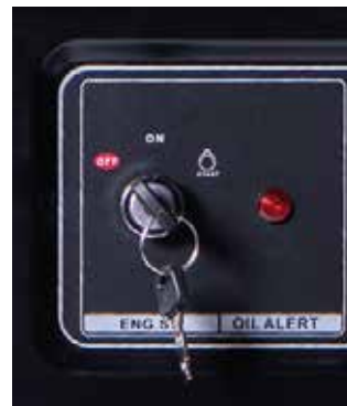
Figura 24 – Interruptor de control del motor
