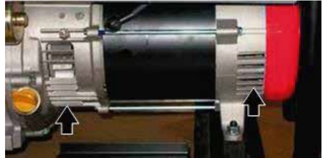
Figura 46 – Entrada de aire de refrigeración y orificio de escape del alternador
