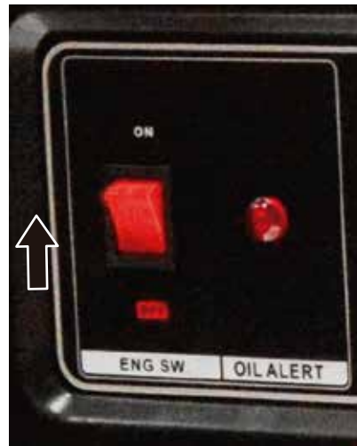
Figura 19 – Interruptor de control del motor
