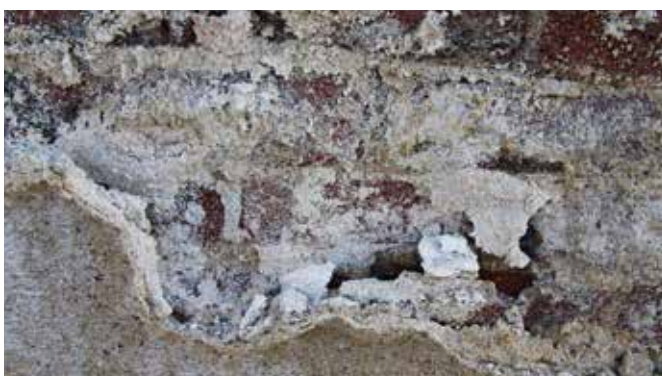
Typische schade door zoutuitslag
