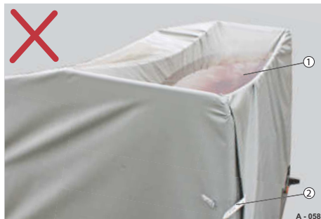
Abb. 66 Beispiel: Wasserlast auf Hochplane
