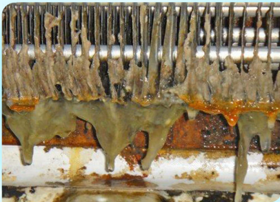
Moho dentro del refrigerador de exhibición
