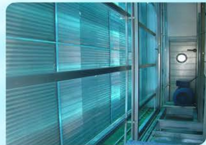
Serpentín limpiado por Steril-Aire
