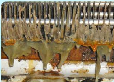
Moho dentro del refrigerador de exhibición
