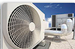
Instalaciones de climatización
