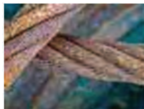
ROUILLE/DÉCOLORATION Le câble est rouillé, orangé par les intempéries ou terni
