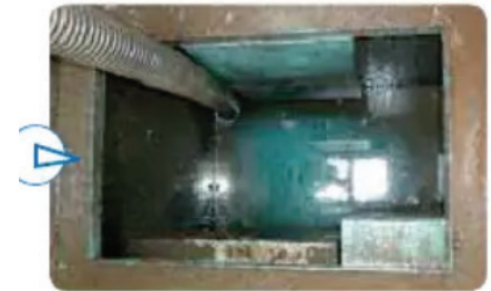
Vidange de la chambre séparateur.
