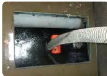
Vue de la chambre séparateur.
