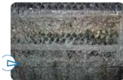
Détail d'un filtre coalesceur fortement chargé en boues et nécessitant intervention.
