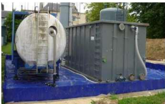
Bac pour matériel dépollution sur chantier
