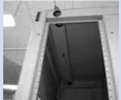
Canales de alambrado
